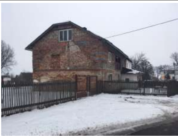
Stavba č.p. 63 – rod. dům, na p.č. st. 64/1, pohled zvenčí č. 1, ze dne 10. 2. 2018
