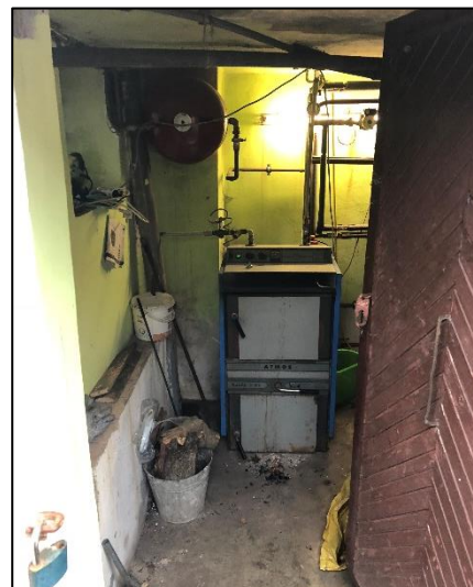
Obr. č. 12 – Suterén domu - kotelna
