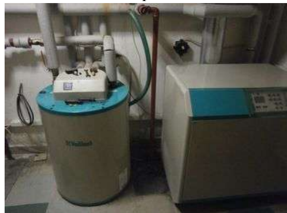
technická místnost sklep
